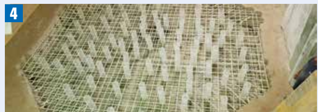
4 À l'issue de la mise en œuvre des armatures Schöck Combar, la dernière étape consiste à couler le béton.
