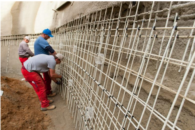
Einbau der elastischen Glasfaserbewehrung Schöck Combar in die organische Form der Baugrubenwandung. Foto: Schöck Bauteile GmbH, Abdruck honorarfrei.
